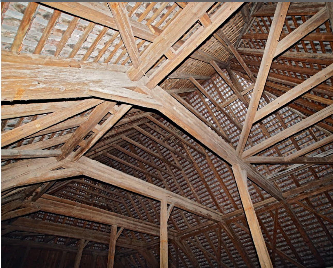
Augst, Hauptstrasse 25. Die Rösslischeune zeichnet sich durch eine moderne Stuhlkonstruk- tion und einen riesigen Lagerraum aus.
