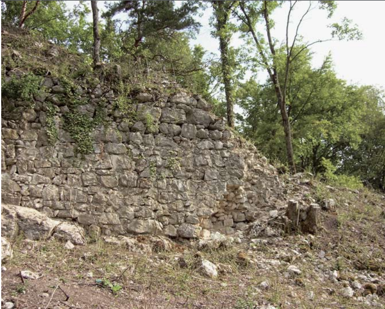
Aesch, Frohberg. Die vom Bewuchs befreite südöstliche Umfassungsmauer mit der Schadenstelle.
