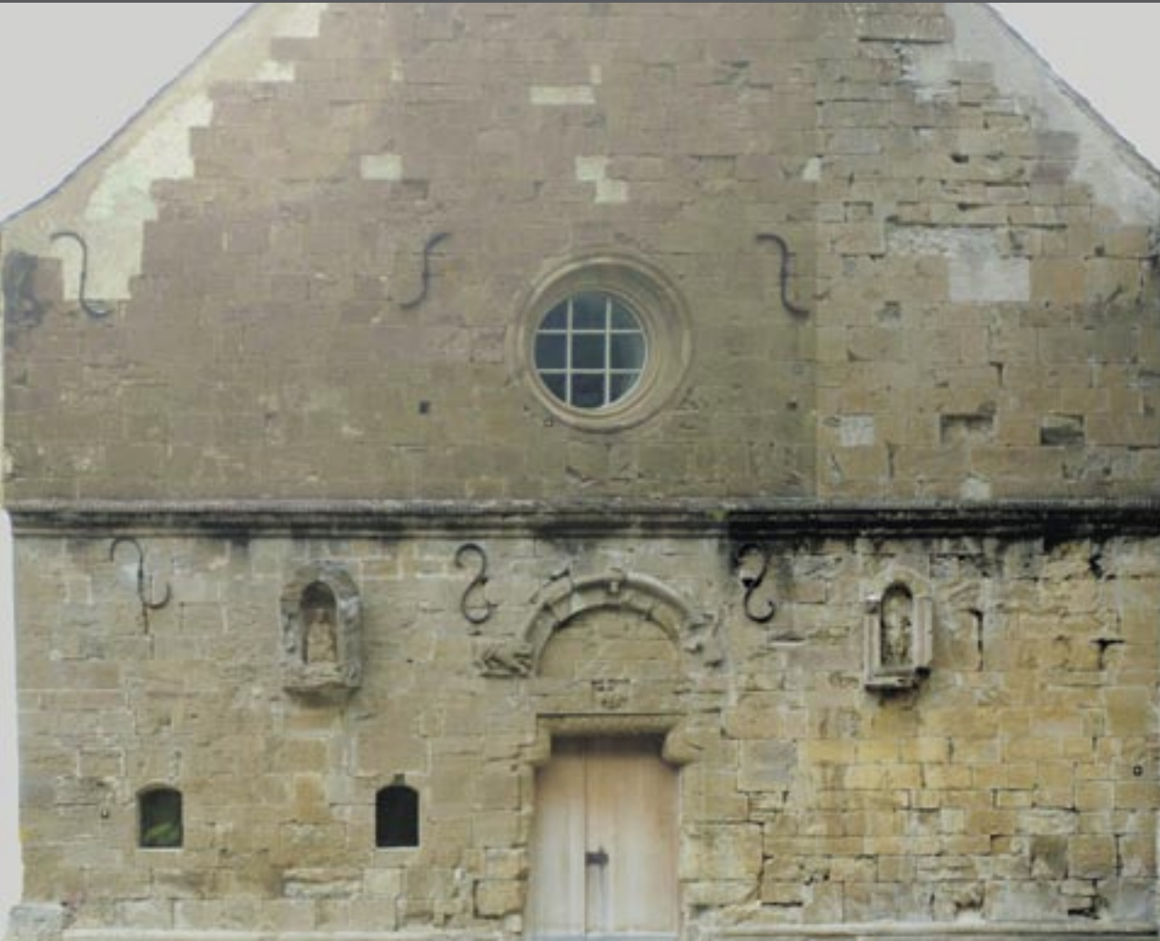
Entzerrte photogrammetrische Aufnahme der Westfassade der Klosterkirche (Institut für Vermessung und Geoinformation der FHNW).
