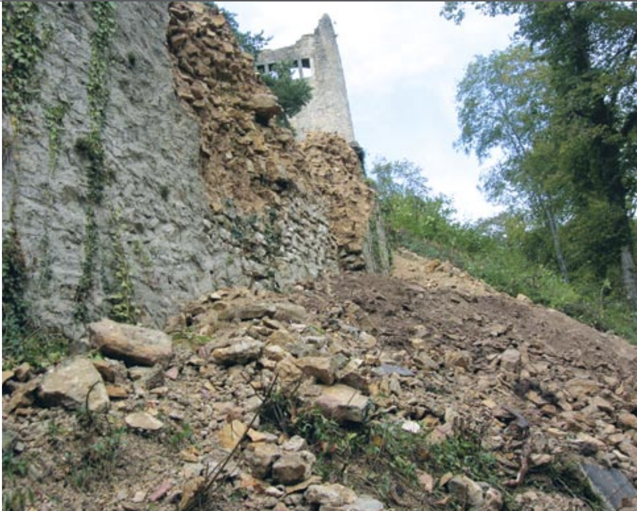
Läufelfingen, Homburg. Schadensbild nach Beginn der der Reparaturarbeiten.
